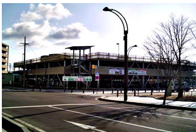
JA佐久浅間(株)アメック佐久平駅前立体駐車場建設工事 〔構造〕鉄骨造 2階建 〔規模〕延面積 4,291.25㎡
